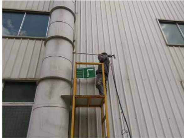
有组织废气: G1 排气筒
